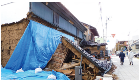
一本杉通りの国登録有形文化財が損壊(七尾市)
