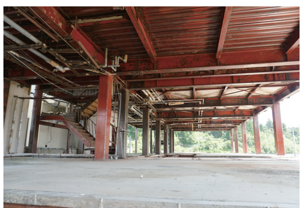
骨組み部分以外が津波で流されたたろう観光ホテルの2階
