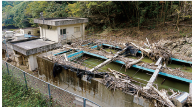
土石流の爪痕が残る吉田浄水場
