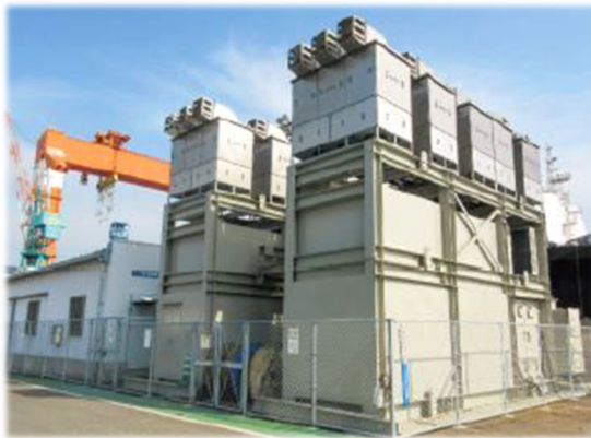
<陸上電力供給設備>
