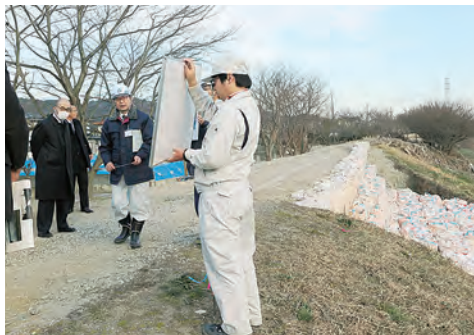
夏井川決壊箇所（いわき市）
